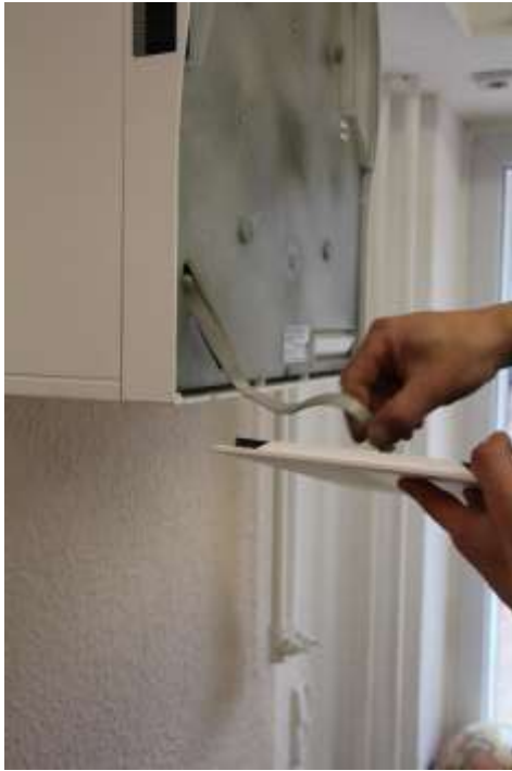
Einbau des Ne xt im Aufenthaltsraum ©LUNOS
